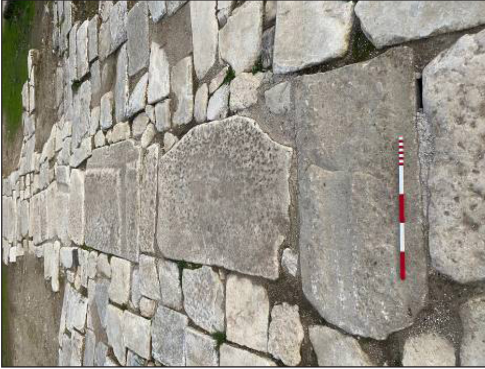
Resim 5: Farklı bloklardan oluşan kanalizasyon kapakları
