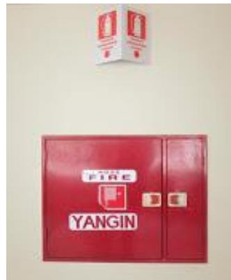
ŞekilHata! Belgede belirtilen stilde metne rastlanmadı..1YangınSöndürmeDolabı
