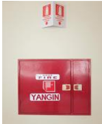
Şekil 7.1 Yangın Söndürme Dolabı
