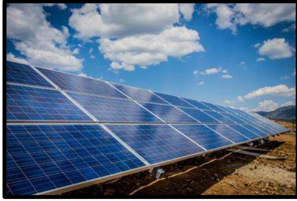
Şekil 389. Güneş Enerji Santrali
