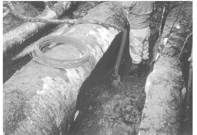
(b) 0.8 m çaplı font boru hasarı
